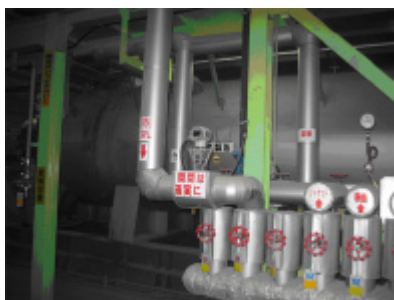
有機原料(牛皮・羊毛)を压力容器で蒸製する分解工場
